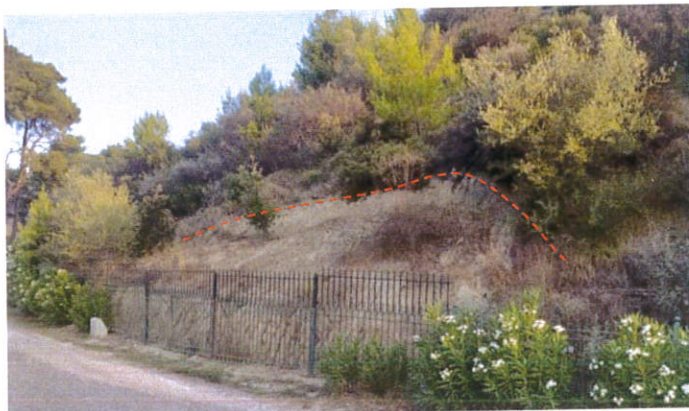
Εικ. 3.6: Επιδερμικές αστοχίες στα πρानή του Κρόνιου λόφου
